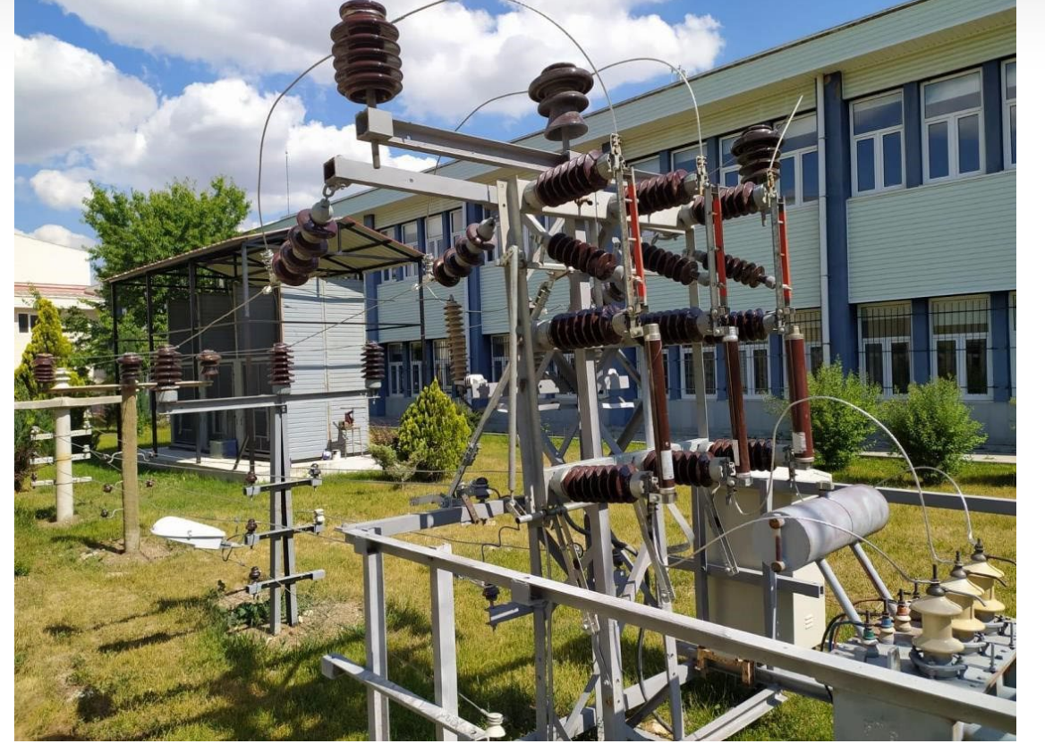
Elektrik Dağıtım Sahası
