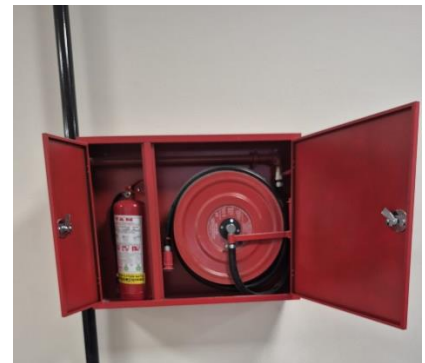
c) Hidrant dolabı ve yangın tüpü
