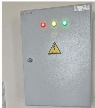
b) Elektrik panosu
